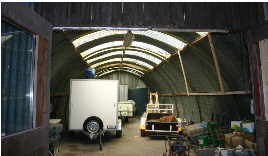
Figuur 4.2.4. De aanbouw is geheel enkelwandig en daardoor ongeschikt voor vleermuizen en gebouwbewonende vogels.
