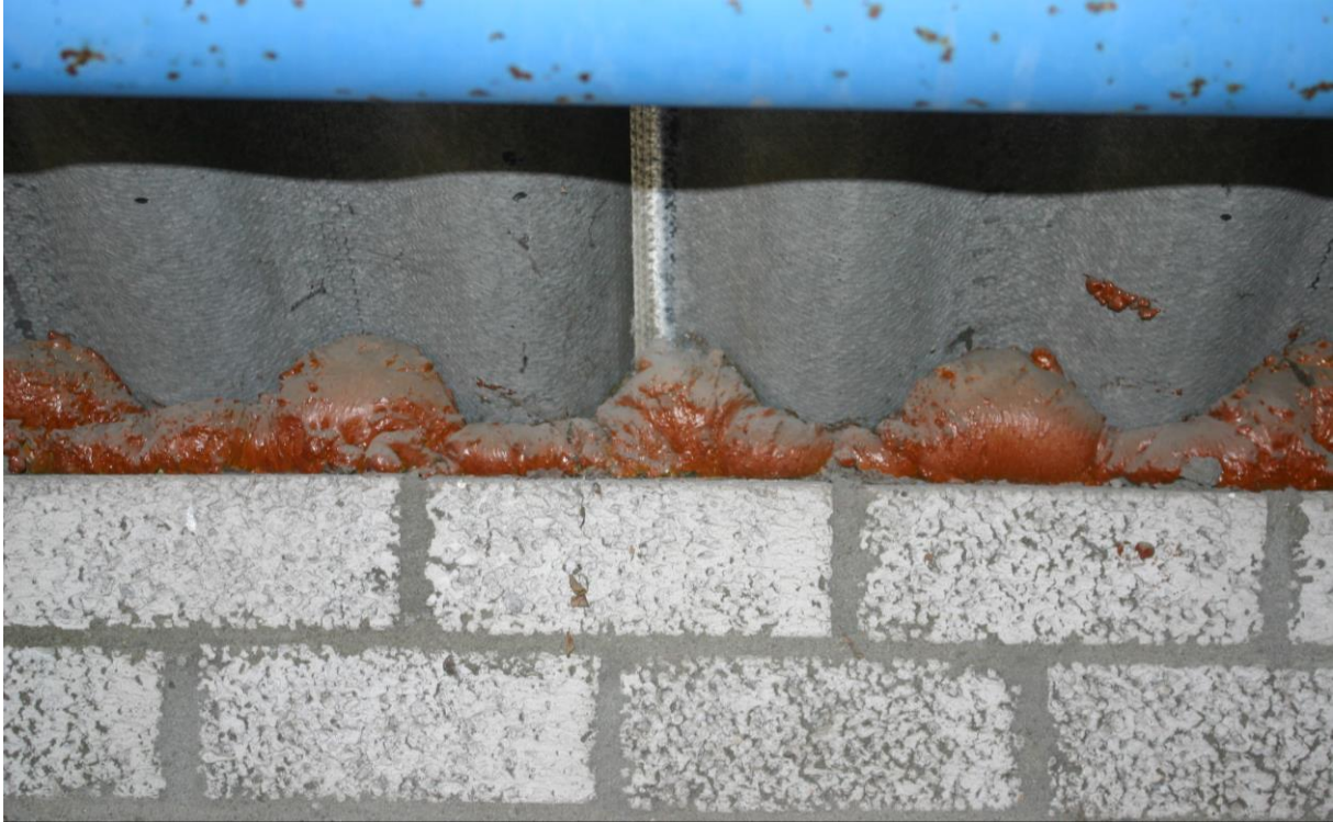
Figuur 4.2.1. Aan de zuidzijde van de loods is de ruimte onder de golflaten geheel afgedicht.
