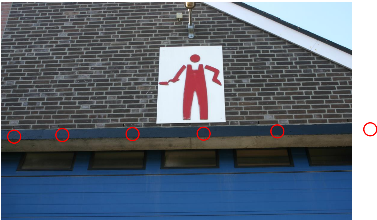
Figuur 4.2.3. In de voorgevel van de loods bevinden zich zes open stootvoegen (rood omcirkeld).
