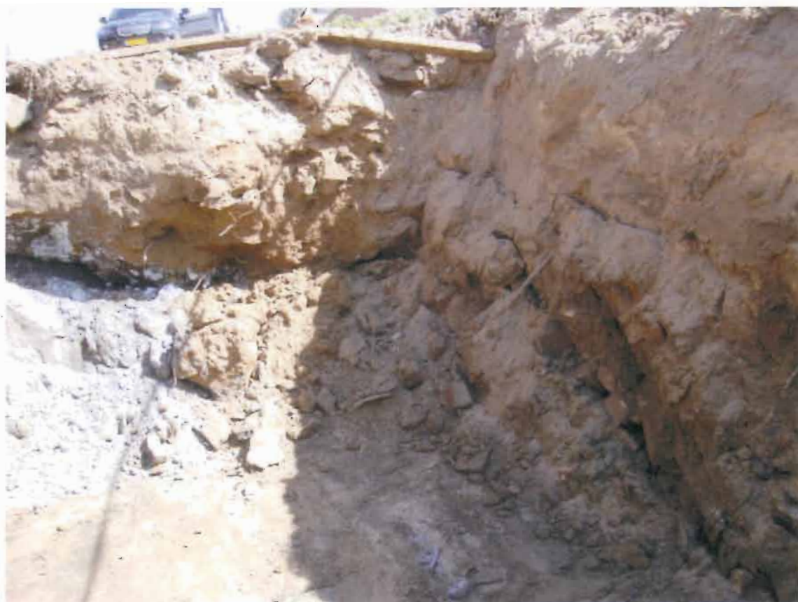
foto 2: zuidoost hoek ontgravingsput sterk verontreinigde grond (gezien vanuit het noordwesten, 1 juni 2011)
