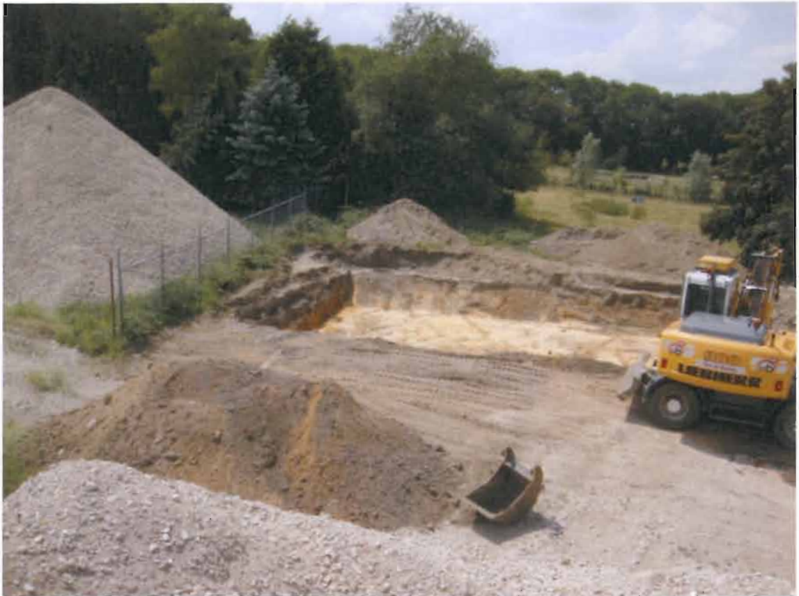
foto 9: overzicht ontgravingsput en depots (I) met zintuiglijk vrijwel schone grond (gezien vanuit het noordoosten, 6 juni 2011)
