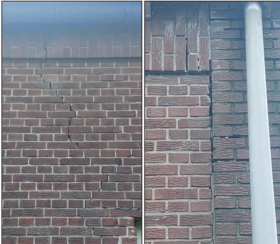
Figuur 4.2.2. Scheuren in de gevels van de schuur waar vleermuizen in kunnen verblijven.
