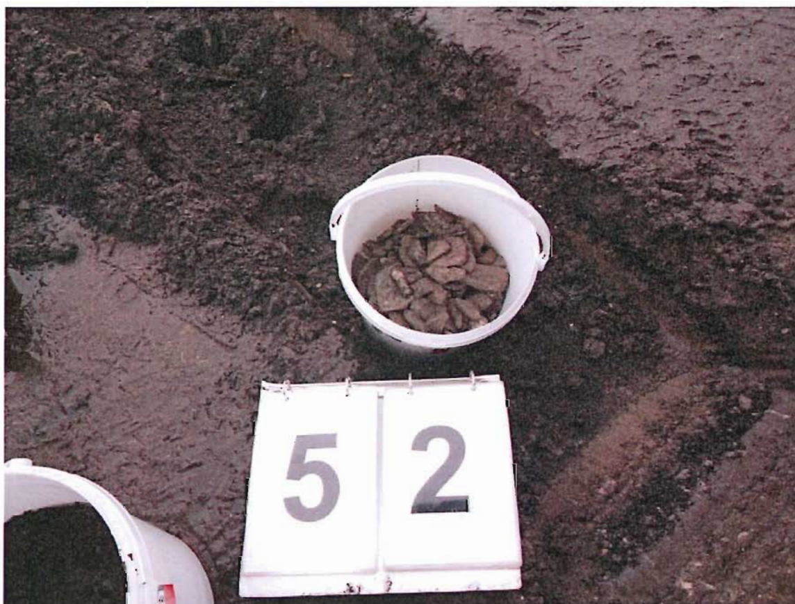
foto 6: asbesthoudende (golf)plaat materiaal en inspectiesleuf S2 (8 februari 2013)
