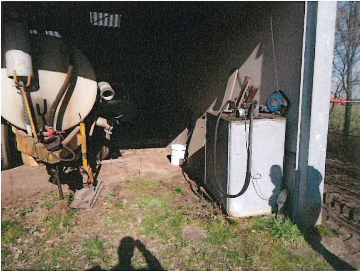
Foto 1: Bovengrondse dieseltank (circa 600 liter) in opslagruimte / veldschuur / (gezien vanuit het zuidoosten, 5 maart 2013)
