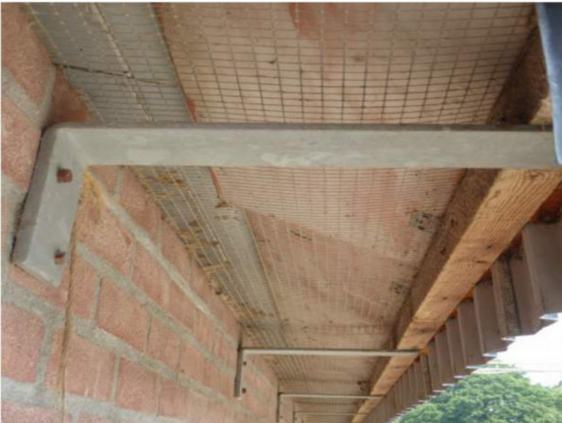
Overhangende dakrand dichtgemaakt aan de onderkant met gaas op varkensstal 4 Foto: [redacted] Ecoresult B.V.
