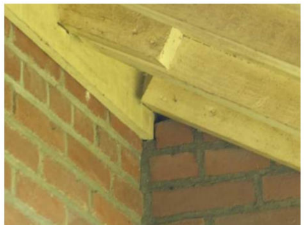
Afbeelding 12: Holte onder dakrand van het woonhuis
