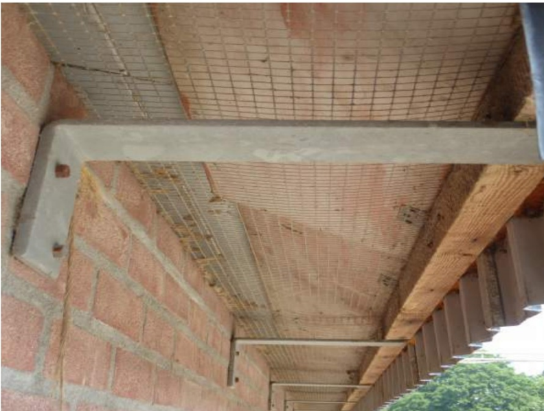
Overhangende dakrand dichtgemaakt aan de onderkant met gaas op varkensstal 4 Foto: XXXXXXXXXX Ecoresult B.V.
