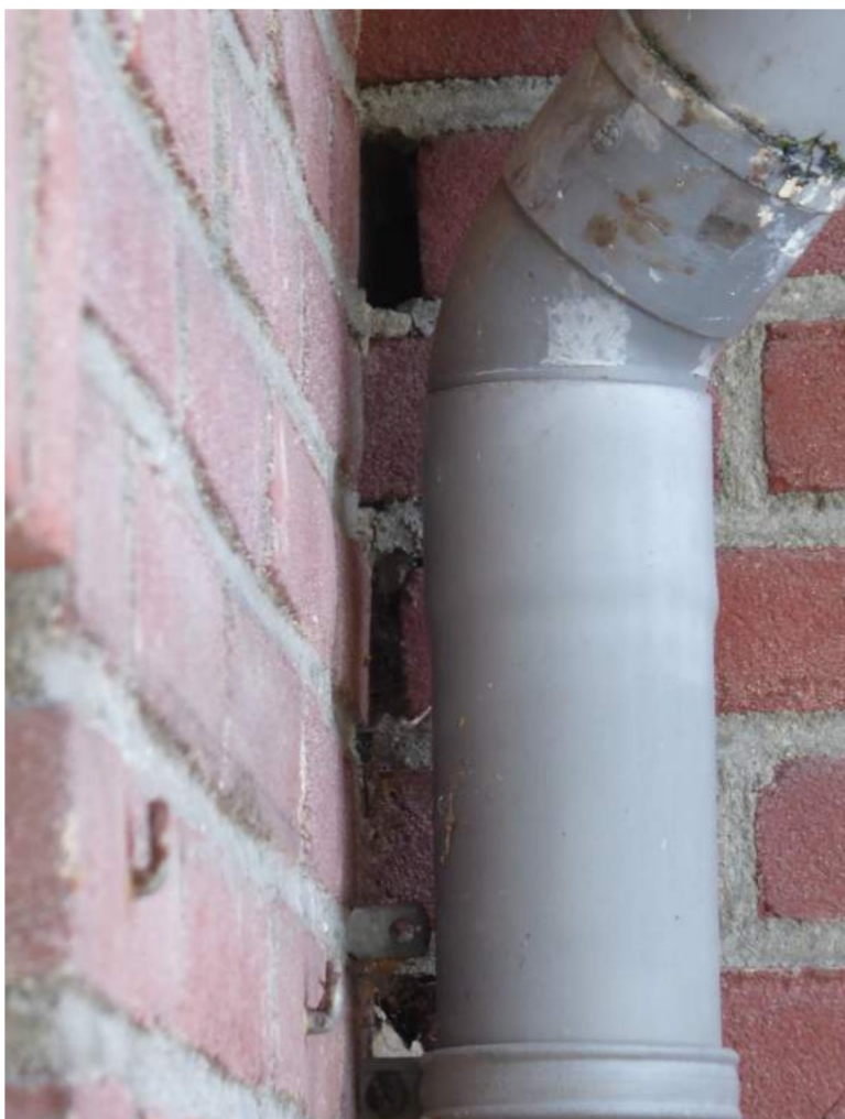
Stootvoegen op woonhuis. Foto: Ecoresult B.V.
