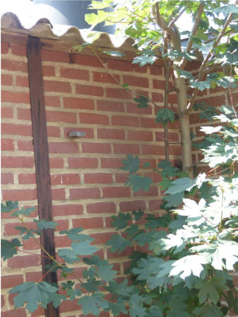
Stootvoeg in gevel van varkenstal 2 . Foto: [redacted] Ecoresult B.V.
