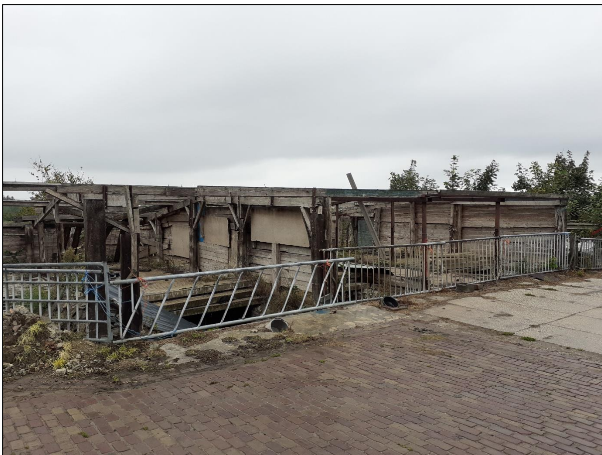
Afbeelding 11. Zicht op restanten van door storm beschadigde stal.
