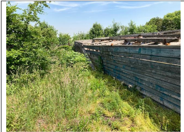
Foto 05 druppelzone ingestorte schuur
