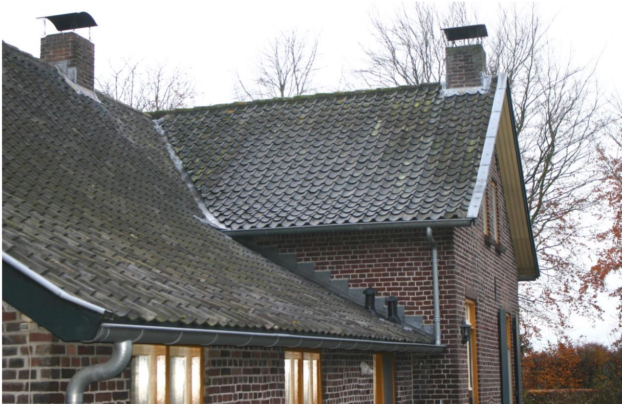
Figuur 4.2.1. Het pannendak van de woonboerderij is niet geschikt voor vogelnesten. Voor de kopsen kanten zit een betimmering (geen ruimte voor gierzwaluwen) en onder de onderste rij dakpannen zit een houten lat (geen ruimte voor huismussen).
