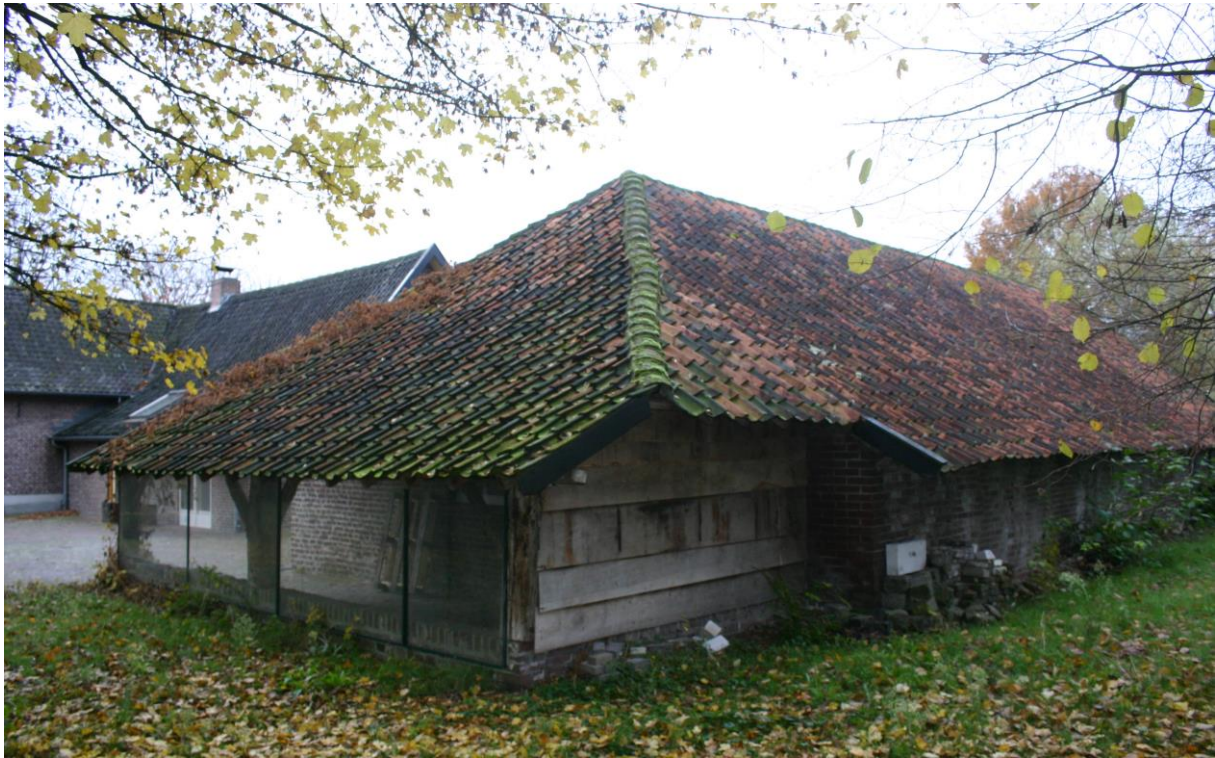
Figuur 4.2.2. De schuur heeft een schilddak; er zijn dus geen overstekende gevelpannen aanwezig waaronder gierzwaluwen kunnen nestelen. Doordat het dak erg laag is en de dakgoot ontbreekt, is de schuur niet geschikt voor huismusnesten.
