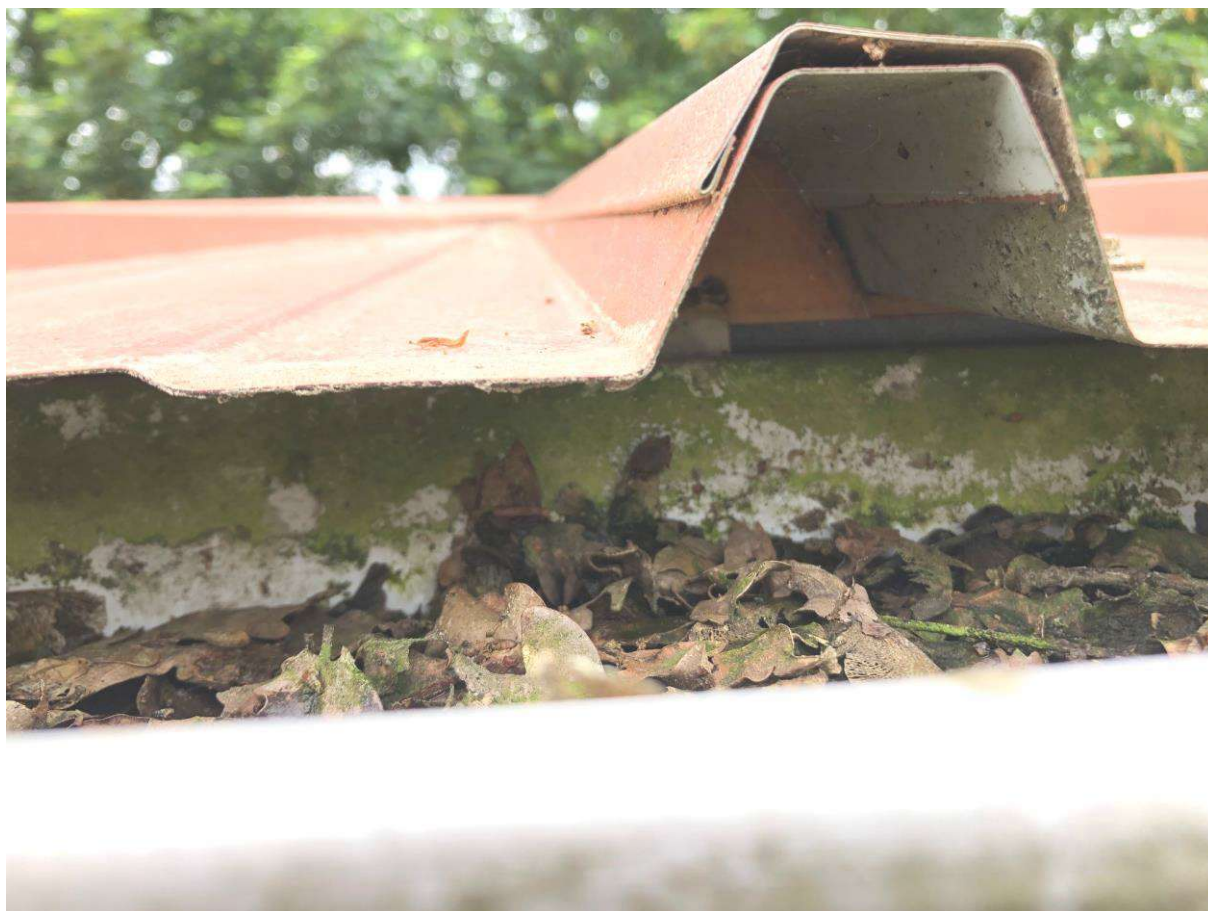
Figuur 4.2.1. Vogelschroot onder de dakpanelen.
