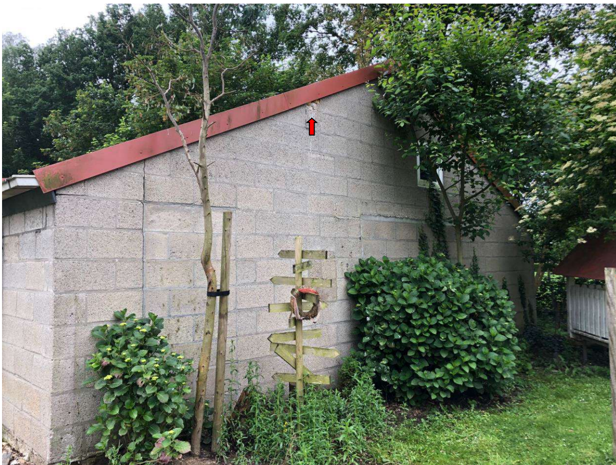
Figuur 4.2.2. Spreeuwnest onder dakpaneel (rode pijl).
