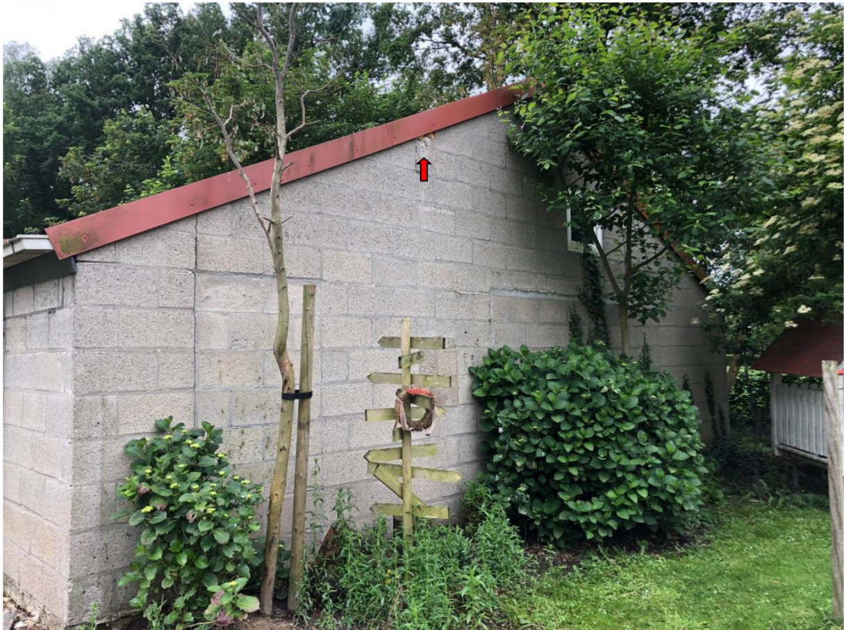
Figuur 4.2.2. Spreeuwennest onder dakpaneel (rode pijl).
