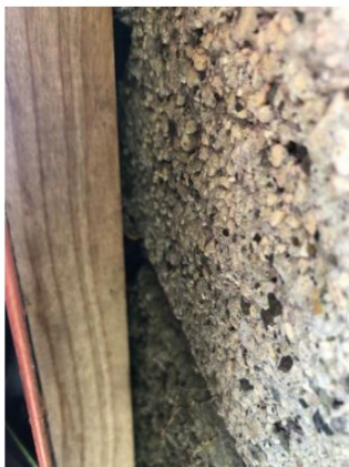
Figuur 4.2.3. De windveer zit met een lat naadloos op de gevel bevestigd.
