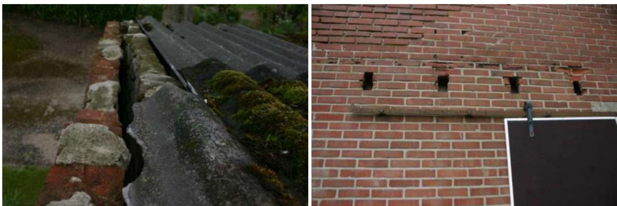
Figuur 4.4.2. De achtergevel is van boven open en bevat grote gaten in de buitengevel, waardoor deze te tochtig is voor vlermuizen.
