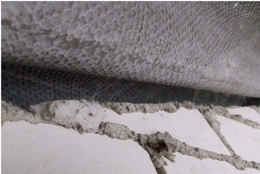
Figuur 4.4.4. Tussen de binnengevel en het dak bevindt zich overal veel spinrag, wat indiceert dat vleermuizen geen gebruik maken van deze opening.
