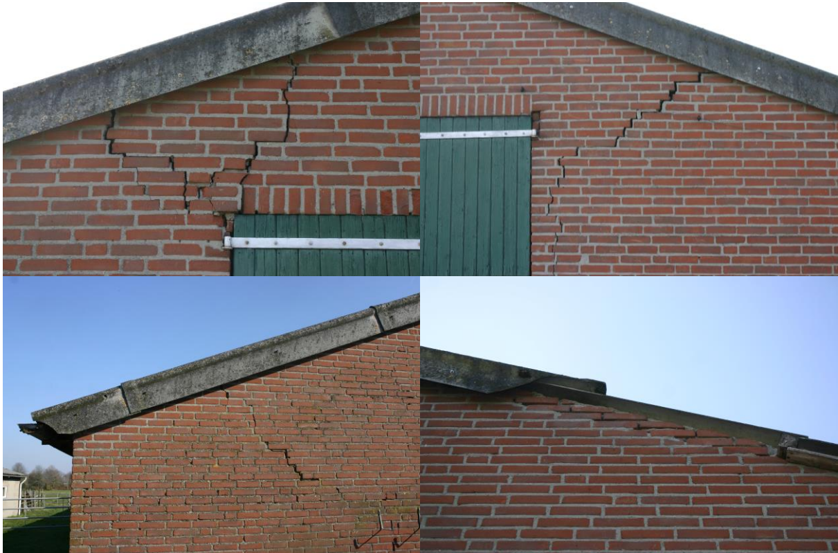
Figuur 4.2.3. De kopgevels van de te slopen melkveestal bevatten meerdere spleten en kieren waardoor vleermuizen de spouw kunnen bereiken.
