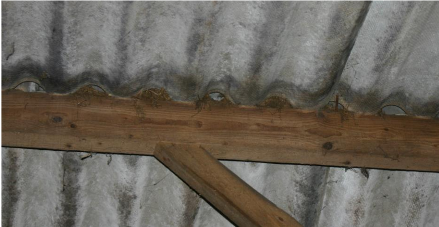
Figuur 4.2.1. Op de nokbalk van de te slopen paardenstal bevinden zich huismusnesten.
