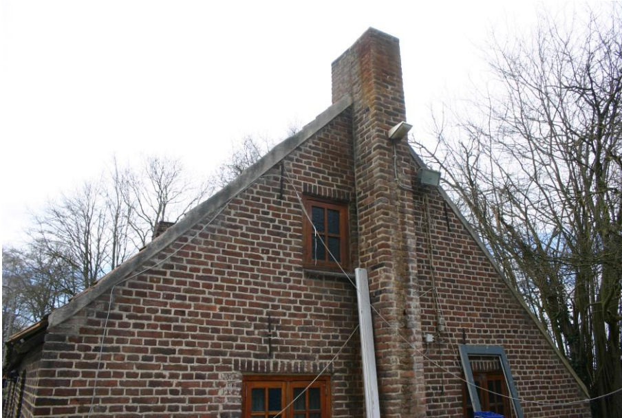
Figuur 4.2.3. De gevelpannen op de zijgevels liggen in de specie. Huismus- en gierzwaluwnesten en vleermuisverblijven zijn hier zeker afwezig.
