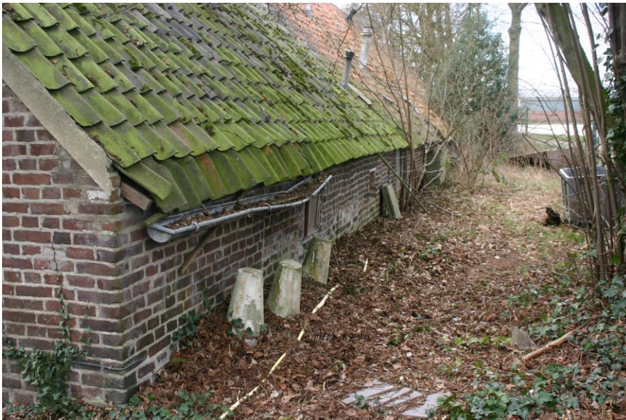
Figuur 4.2.2. De onderste rij dakpannen op de achtergevel bevinden zich te laag bij de grond om als toegang voor vogels te dienen.
