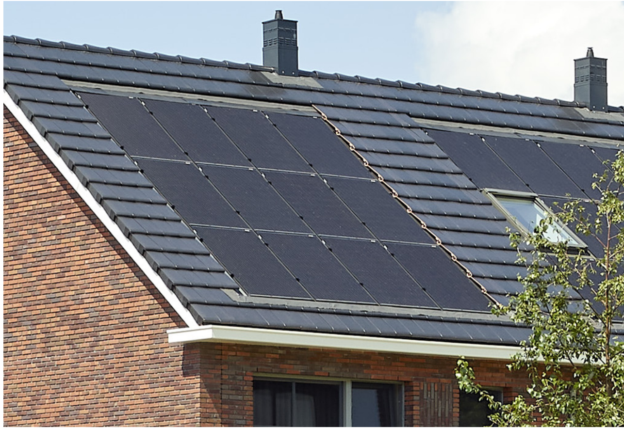
referentie PV panelen geïntegreerd en qua kleur passend bij dakpannen
