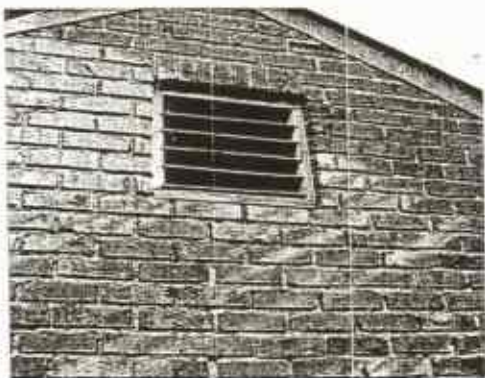
Foto 8: Luchtrooster in de muur (A4).
