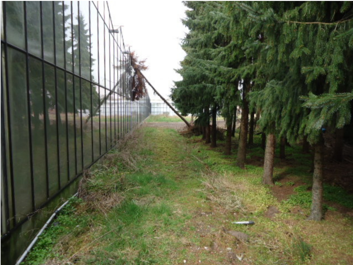
Foto 15: Verharding van gebroken puin ten noord(oosten) meest noordelijk gelegen tuinderskas (gezien vanaf het oosten, 31 maart 2014)
