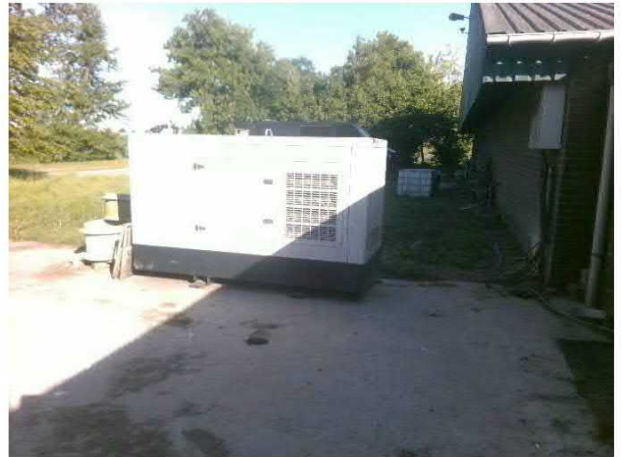
Foto 20: noodstroomaggregaat met dieseltank
