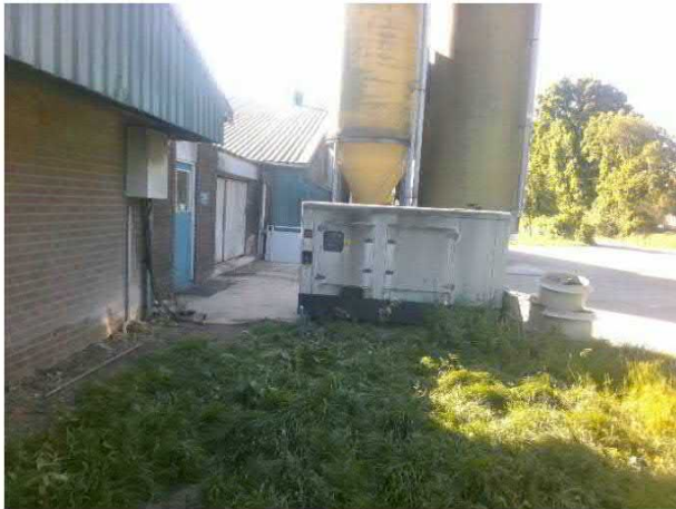
Foto 19: noodstroomaggregaat met dieseltank
