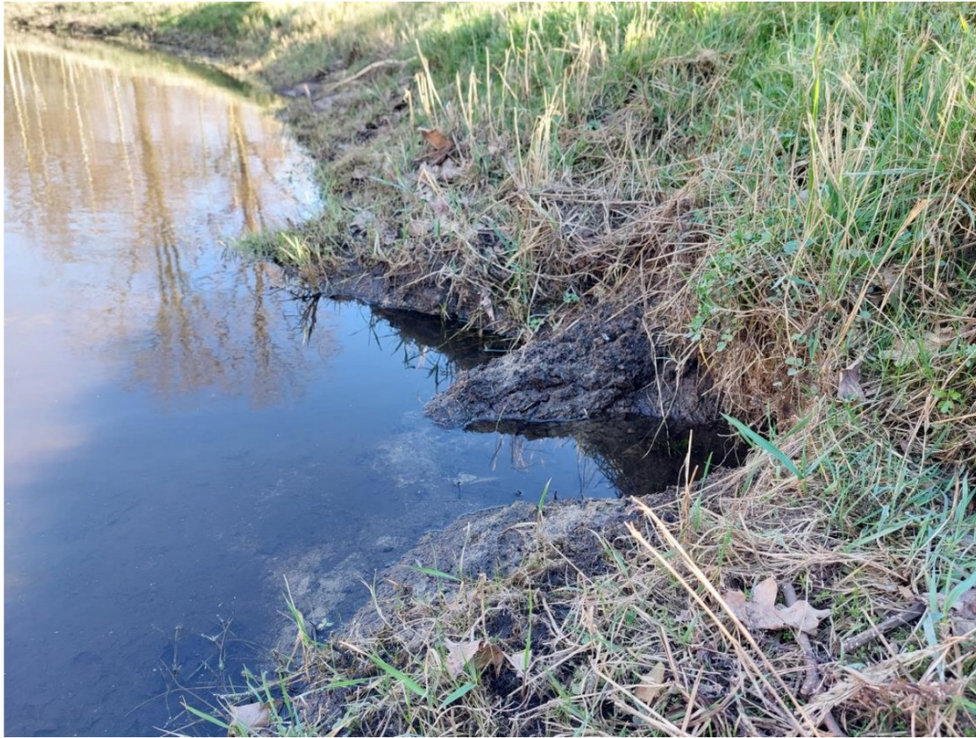
Afbeelding 37: Een van de vele oeverholen in het talud van de Boabel.
