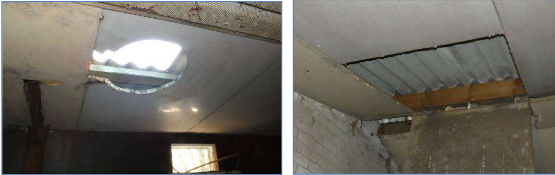
Foto 14 en 15 Grote gaten / beschadigingen en losse platen in isolatie gebouw 2
