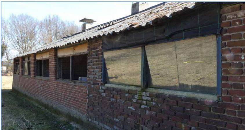
Foto 18 lage zijmuur gebouw 1 met veel tochtige openingen
