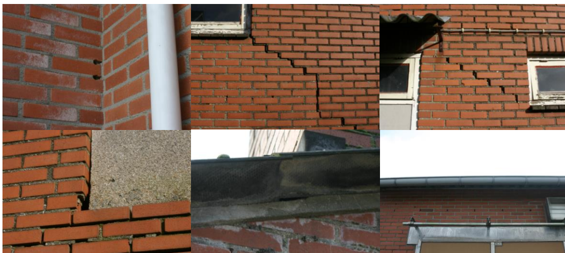
Figuur 4.2.1. Het opslaggebouw bevat meerdere kieren en gaten, en open stootvoegen waardoor vleermuizen de spouw kunnen bereiken.
