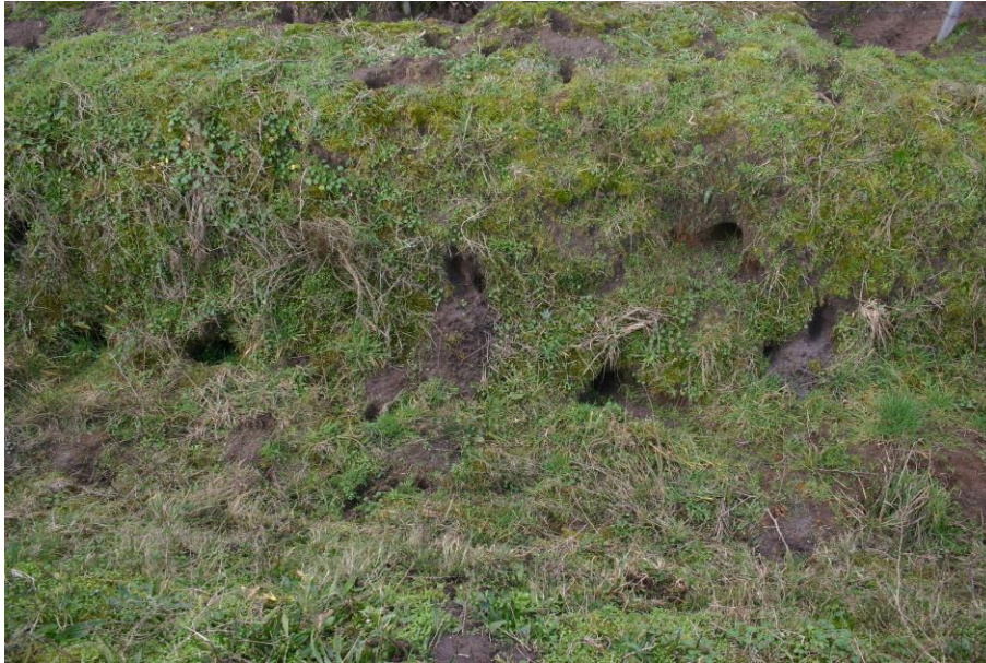
Figuur 4.2.3. In de greppel in deelgebied 1 zijn holen en graafsporen van konijnen aanwezig.
