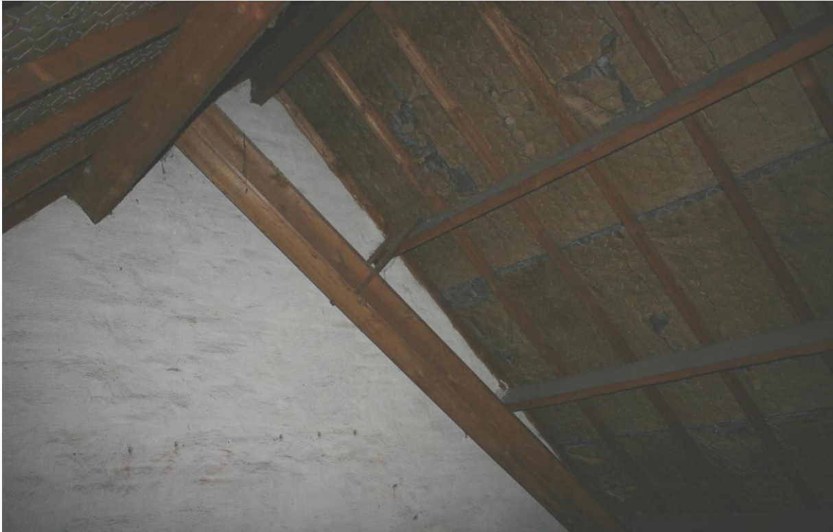
Figuur 4.2.1. Onder de dakpannen is kippenaas gespannen, waarop een zeer dunne laag glaswol is aangebracht. Her en der is de glaswol stuik en zijn er dakpannen zichtbaar.
