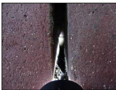
Figuur 14. Stootvoeg, geeft toegang tot de spouwmuren.
