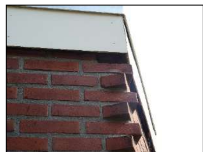
Figuur 16. Spleet onder de dakrand, geeft toegang tot de spouwmuren.
