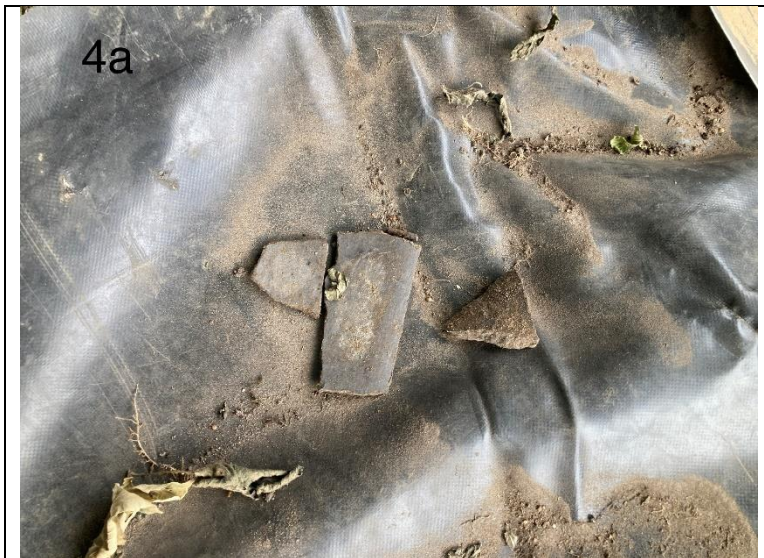
Foto 2: asbesthoudend materiaal proefsleuf C4a
