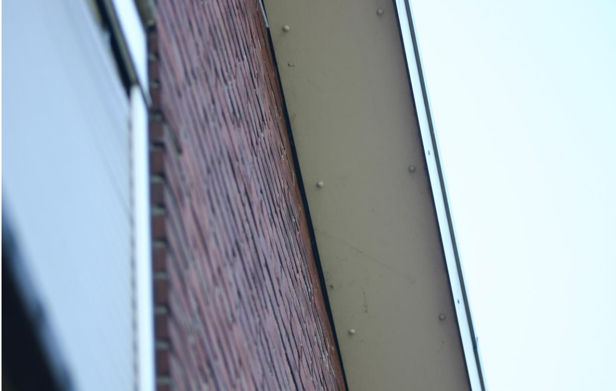
Figuur 4.2.2. De woning heeft een kierende dakoverstek waardoor vleermuizen het gebouw in kunnen.
