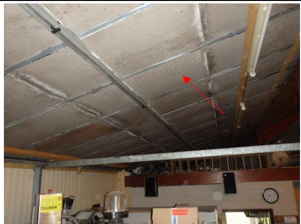
onder metalen dakplaten asbesthoudende platen aanwezig
