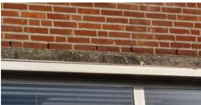
Figuur 7: Open stootvoegen boven raamkozijn in zuidgevel
