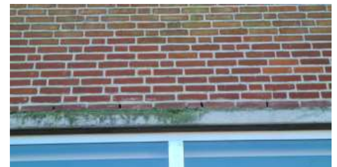
Figuur 9: Open stootvoegen boven raamkozijn in noordgevel
