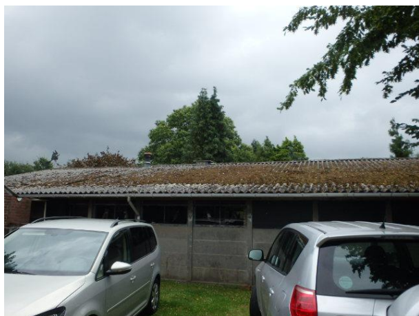
Foto 1: Asbestverdacht dak kippenschuur
