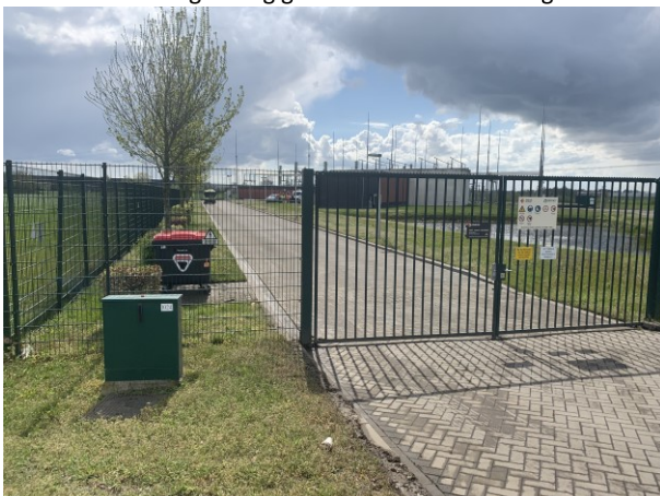
Foto 11 Verdeelstation Enexis gelegen aan de Horsterweg
