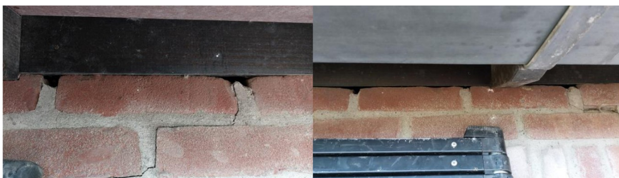
Figuur 4.2.5. De garage bevat spleten tussen de gevel en de muurplaat.
