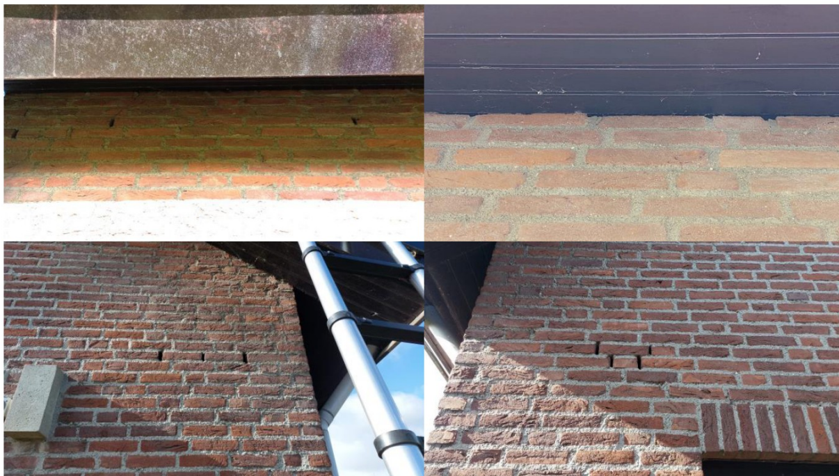
Figuur 4.2.4. De woning bevat meerdere open stootvoegen en enkele pletten tussen de gevel en het dakoverstek.
