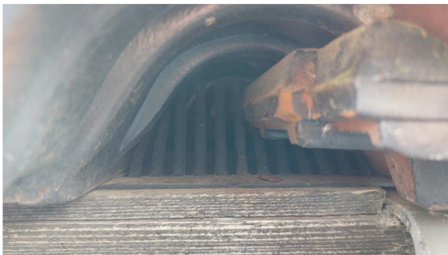
Figuur 4.2.1. Onder de onderste rij dakpannen bevindt zich vogelschroot.
