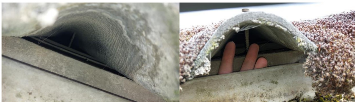
Figuur 4.2.7. Vogelschroot is afwezig en de dakgoot sluit niet nauw aan op de gevels.
