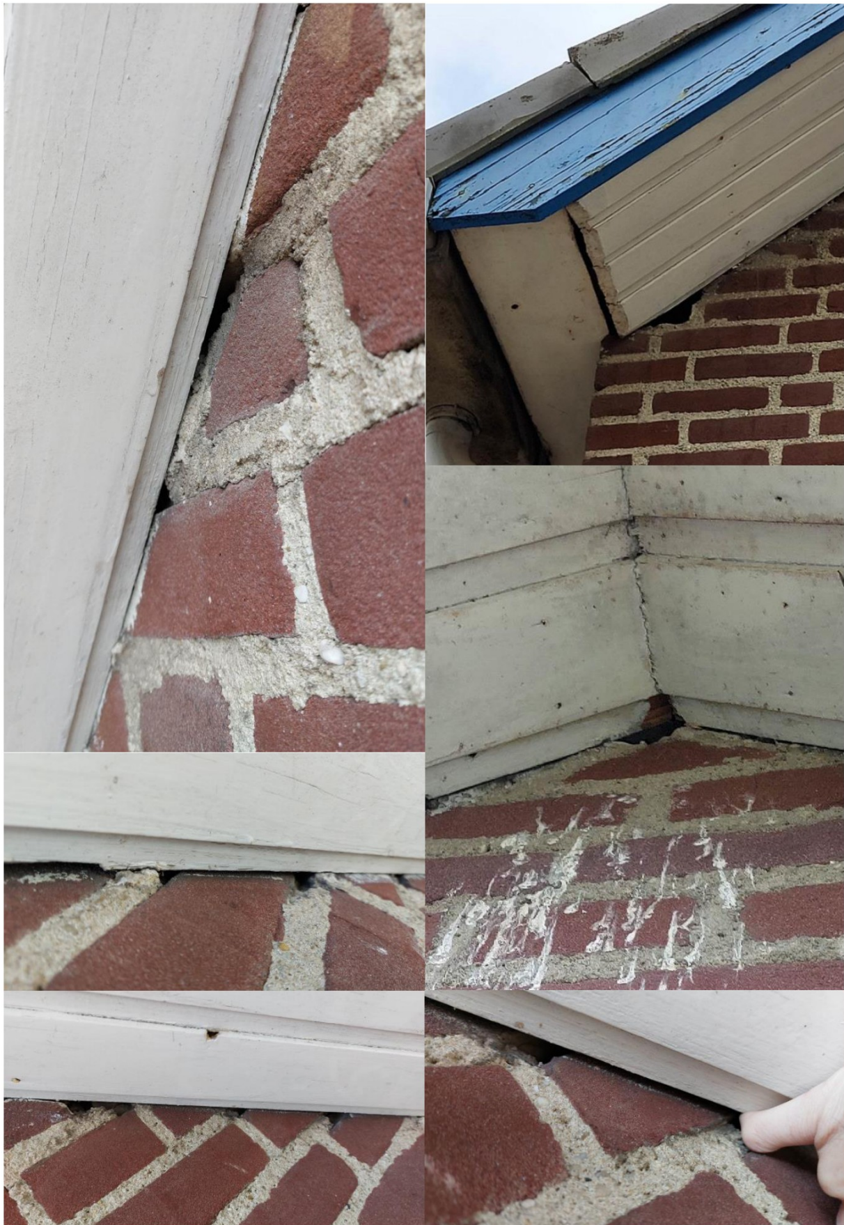
Figuur 4.2.6. Vleermuizen kunnen via openingen en spleten achterliggende ruimtes bereiken.
