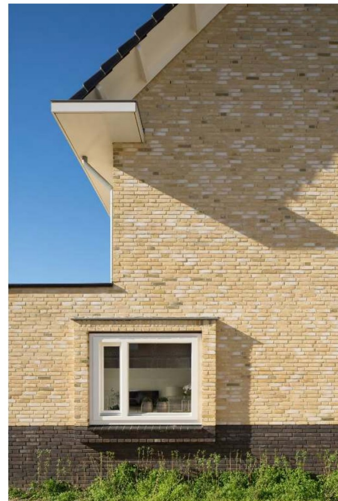
Detaillering in kopgevel en overstek (gele kleur baksteen niet wenselijk in deze omgeving)
