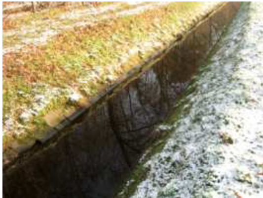
Aanvoerleiding Meteriks Veld
