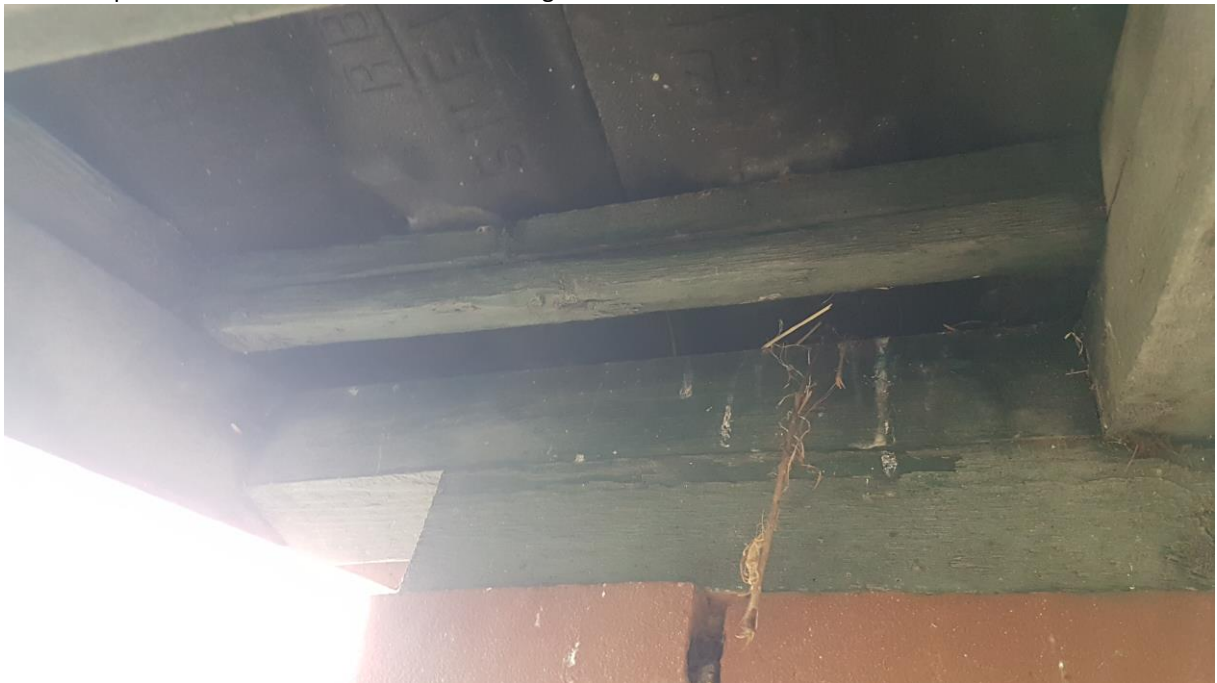
Foto 14: nestmateriaal aangetroffen op de muurplaat in de zuidoostelijke hoek van de varkensstal.
